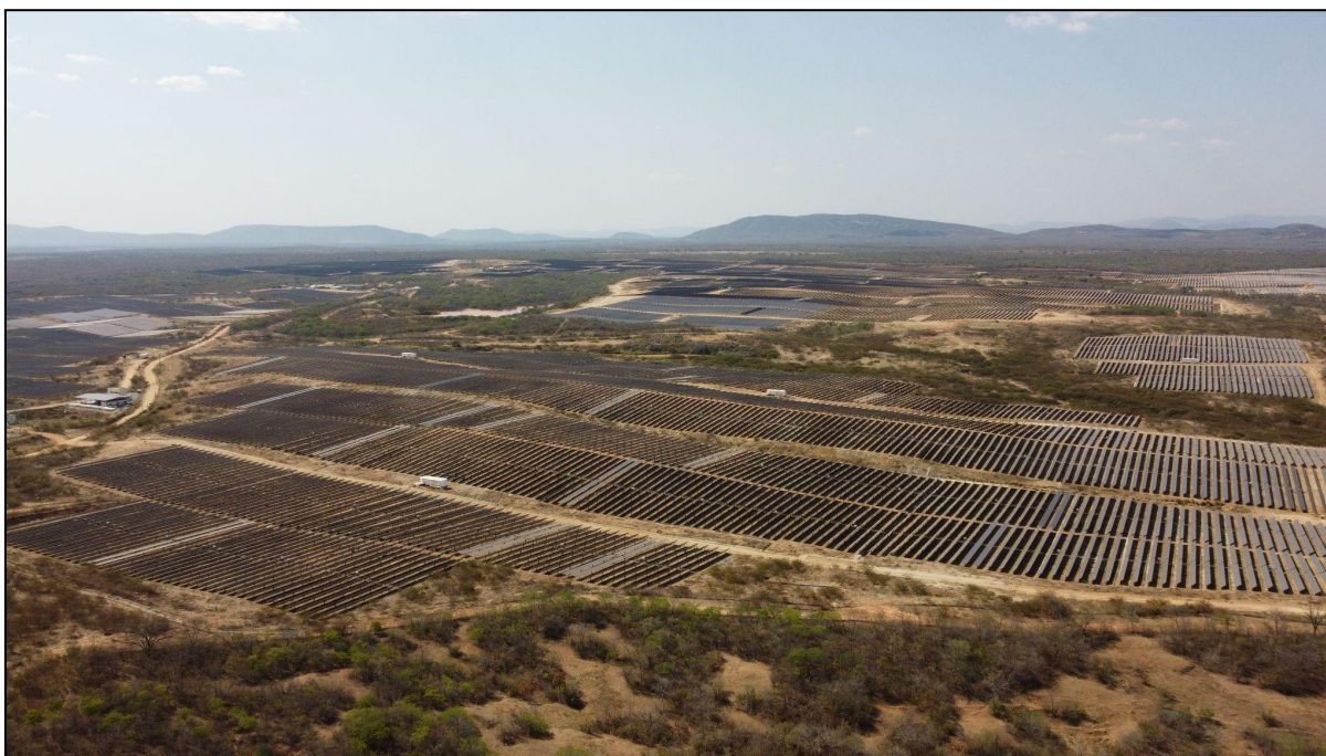
REGISTRO FOTOGRÁFICO 05 - VISÃO PANORÂMICA DA USINAS FOTOVOLTAICAS EM COREMAS (OUT 2022)
